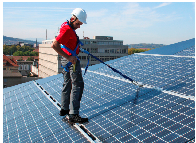
3 Installation photovoltaïque avec protection contre les chutes pour l'entretien et la maintenance (à utiliser comme système de retenue).
