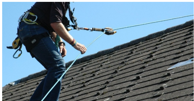
1 Dès la prise de mesures, il existe un risque de chute. Des mesures de protection appropriées sont indispensables.
