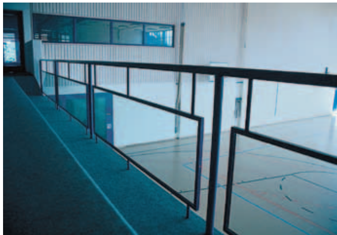
Espace réservé au public: dispositif de protection contre les chutes en verre de sécurité feuilleté, vue dégagée sur les terrains de jeu, pas d'ouverture supérieure à 12 cm de diamètre jusqu'à une hauteur de 75 cm
