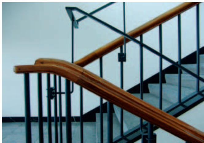
Mise aux normes d'un bâtiment historique: main courante surélevée
