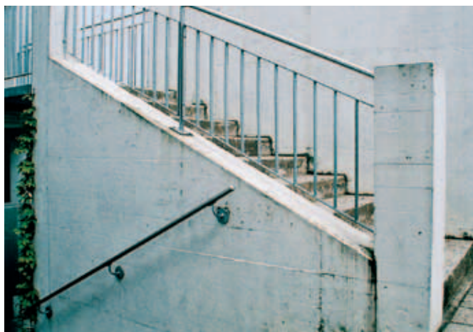
Escalier de plus de cinq marches: main courante, barreaux verticaux de protection contre les chutes
