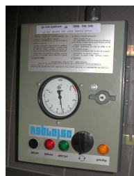
Système Vacuum (vide gazeux) pour réservoir à simple paroi Contrôle de fonctionnement annuel
