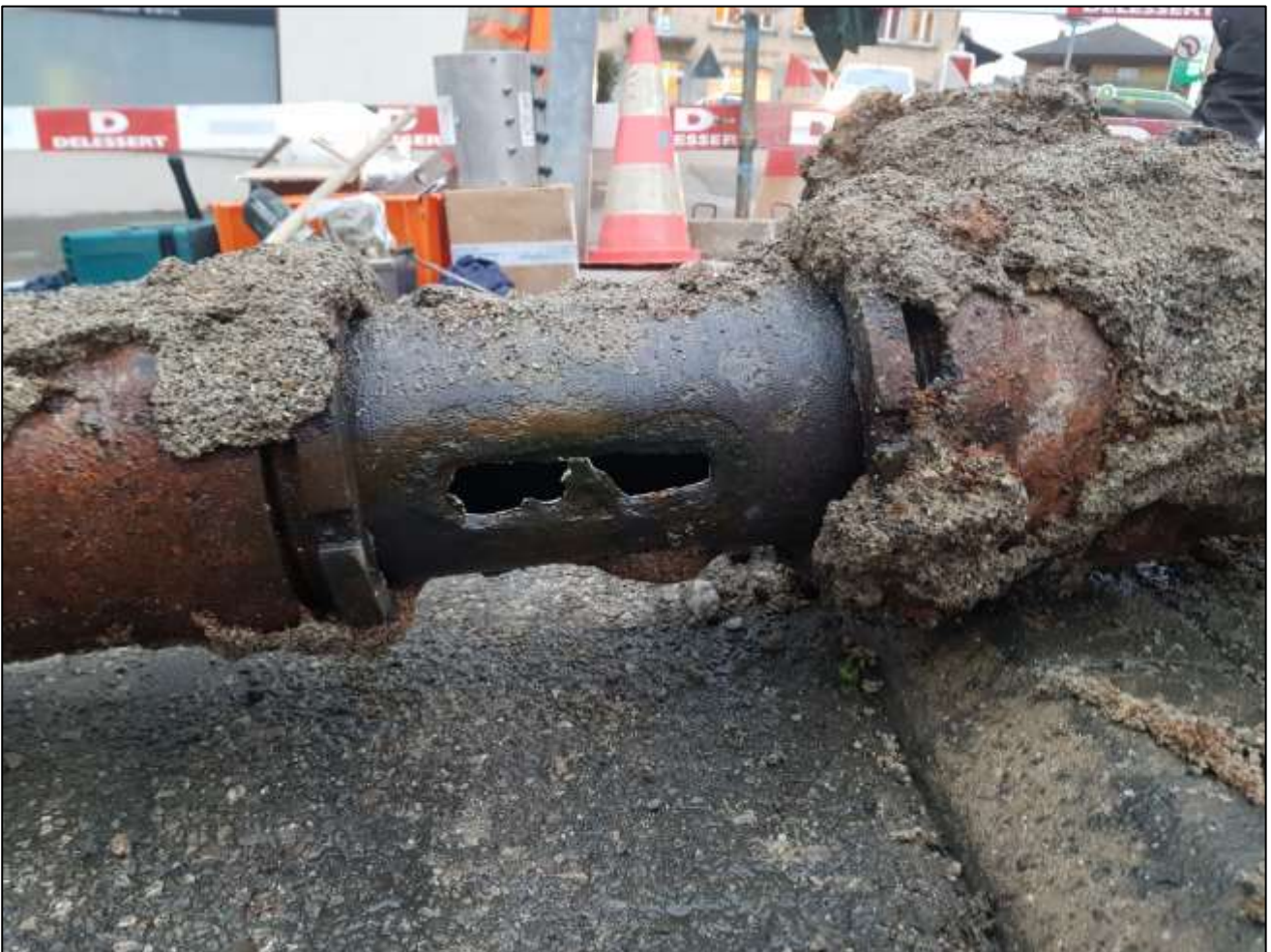
Fuite au Bourg, Oron-la-Ville
