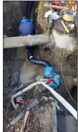
Raccordement sur tripléte en face de la gare
