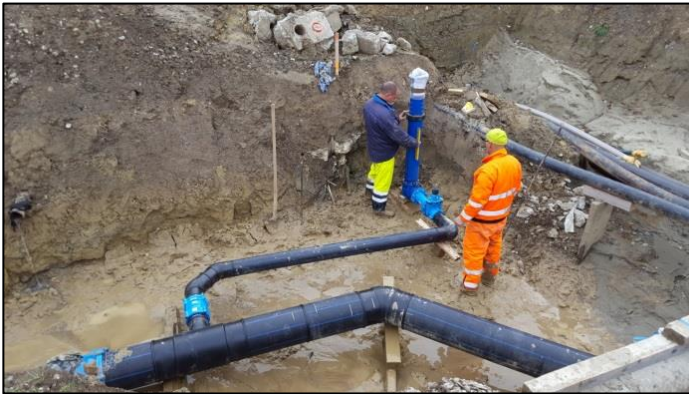
Installation proche de Streetbox
