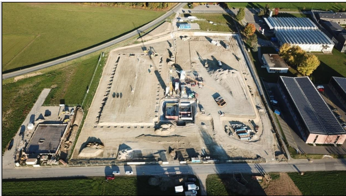
Photo prise le 16 octobre 2017 chantier Mika Déménagements Transports SA à gauche et Norba SA au centre
