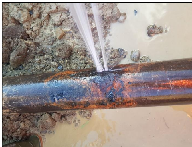
Fuite sur conduite en fonte à la Route de Bossonnens, Ecoteaux
