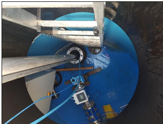
Puits du Very pendant la sortie de la pompe (-21mètres)
