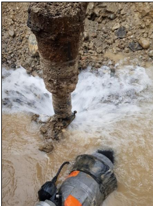
Fuite sur vanne de branchement privé, Châtillens
