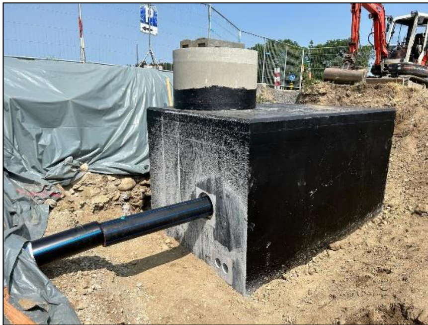
Chambre de comptage Mobilidoux, Palézieux-Village
